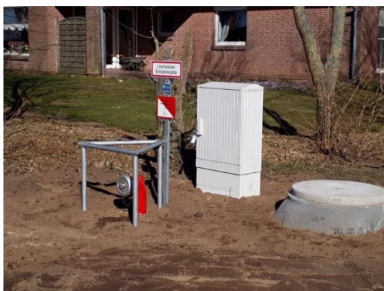
Abbildung 47 Löschwasserbrunnen mit Tiefpumpe
