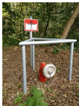
Abbildung 48 Löschwasserbrunnen ohne Tiefpumpe
